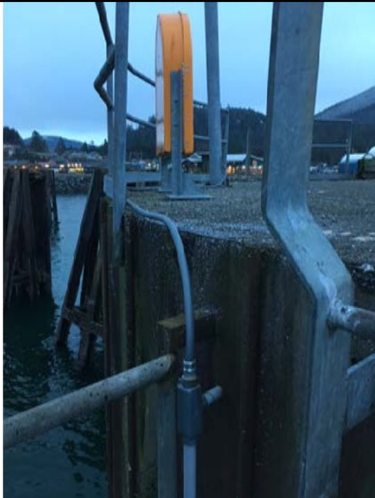
Conduit to Dolphin
