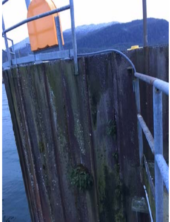
Conduit to Dolphin
