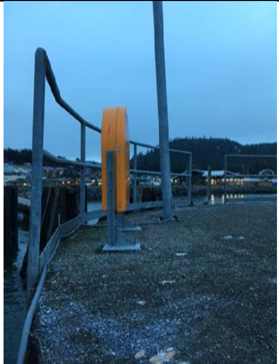
Conduit to Dolphin
